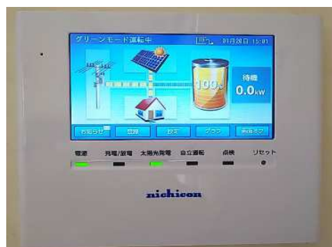
蓄電所「れんたくん1号」のモニター
